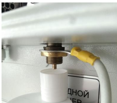
Рисунок Б1.1 – Проверка дозатора
